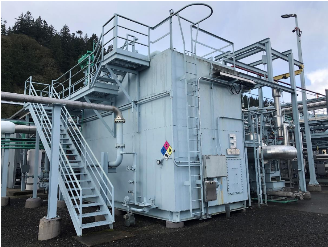
Figure 6.24: Portland LNG Cold Box
