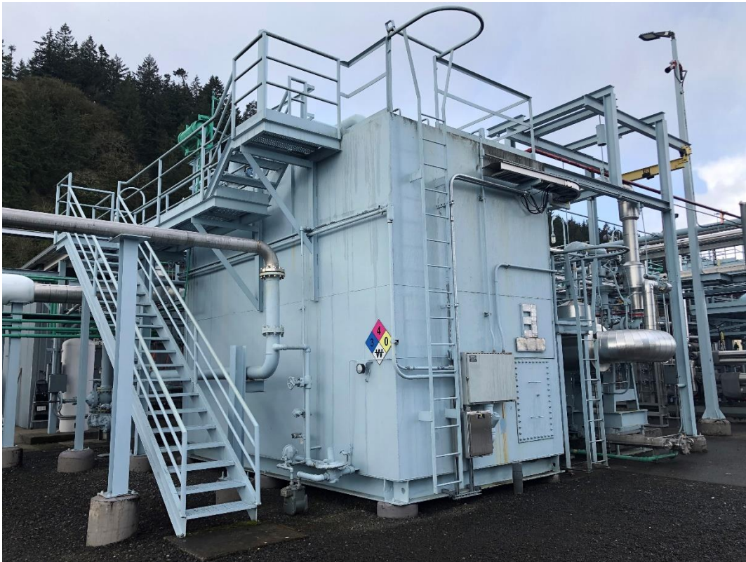
Figure 6.12 Portland LNG Cold Box
